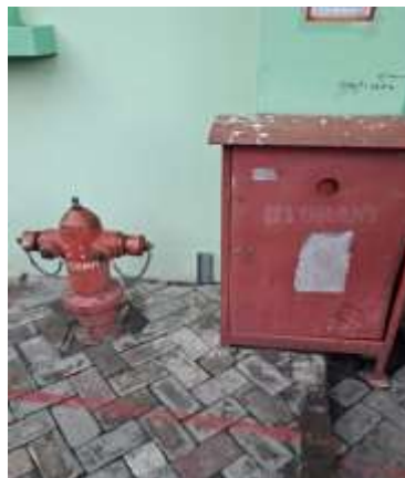
Gambar 2. kondisi hydran di RS X Surabaya
